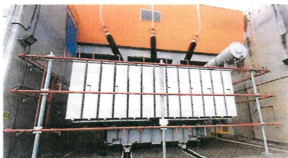
Figura 1 - Vista Frontal do transformador elevador em sua "bala".
