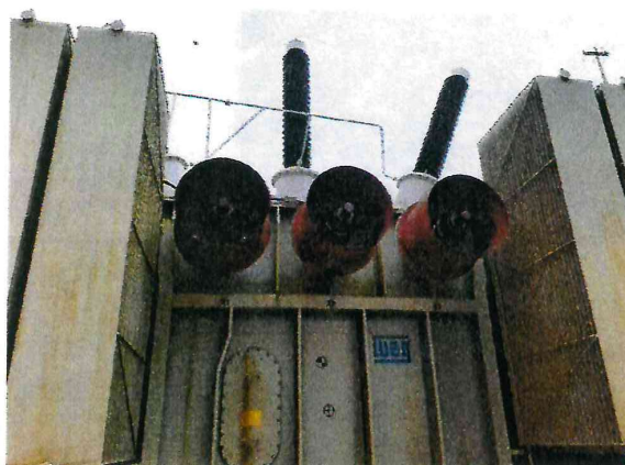
Figura 9 - Detalhe das buchas de BT
