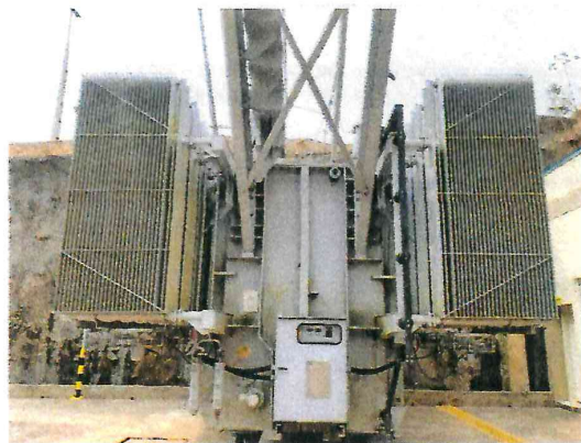
Figura 2 - Vista lateral do transformador elevador reserva localizado na "bala" de permanência e manutenção.
