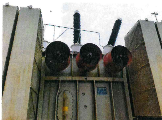
Figura 9 - Detalhe das buchas de BT
